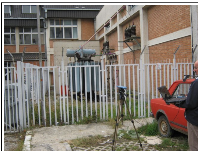
Мерна тачка Т1 Лимска 25, десна страна зграде, између трансформатора и стамбене зграде 5 m од трафоа
