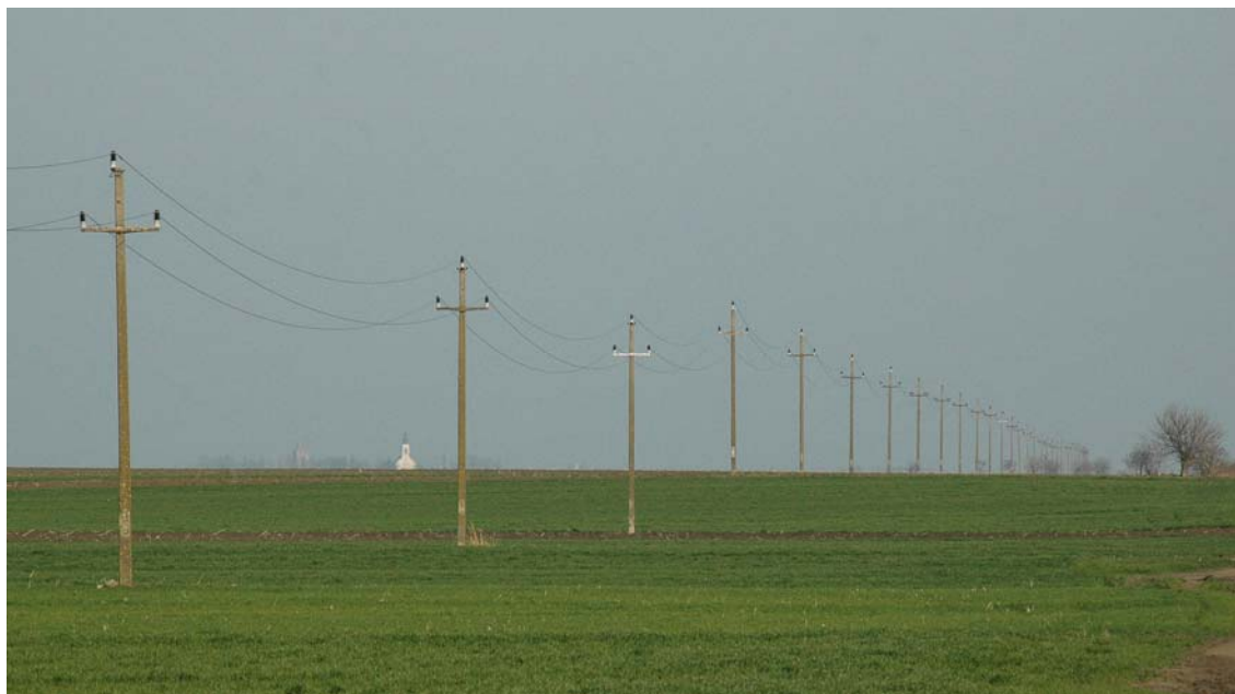
Слика 9 – Електровод Дебељача – Опово
